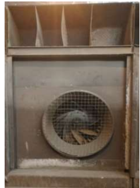
Рисунок 4 – вентилятор в печи
